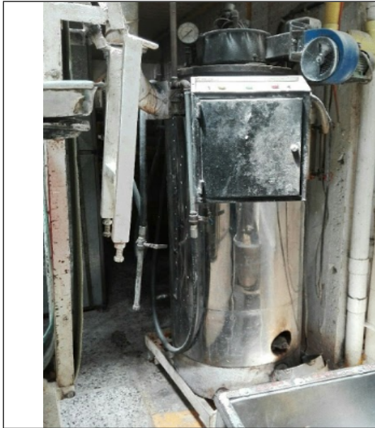
Fotografía N°. 5 Caldera 20 BHP
