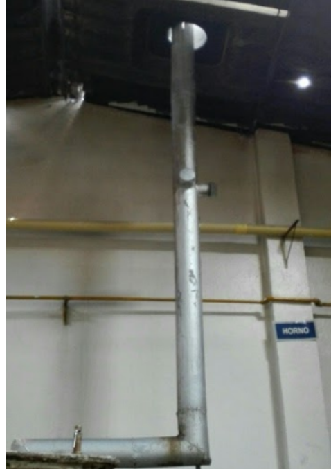
Fotografía N°. 8 Ducto y puertos de muestreo
