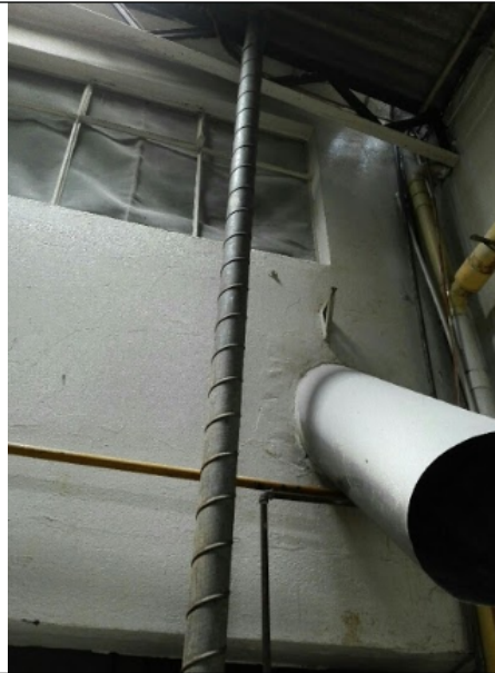
Fotografía N°. 6 Ducto Caldera
